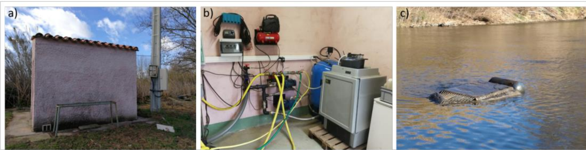
Figure 5 : Station de mesure de Villelongue-de-la-Salanque . a) Station de mesure. b) Système de pompage avec préleveur Teledyne ISCO 6712FR . c) Radeau.
